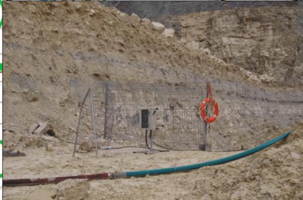
Canalisation des eaux de ruissellement vers les bassins intermédiaires
